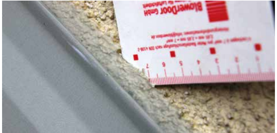
Beim Anschluss an alte (fremde) Fassaden bei geschlossener Bauweise kommt es sehr häufig zu Putzschäden oder Ablösung der Dichtstoffuge gemeinsam mit dem Oberputz entlang der Putzleisten bei Einsatz von MS-Polymer Hybriddichtstoff.
