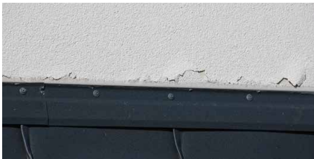
Die Schubspannung am Untergrund in Folge des aufgeschobenen Oberputz ist sehr deutlich.
