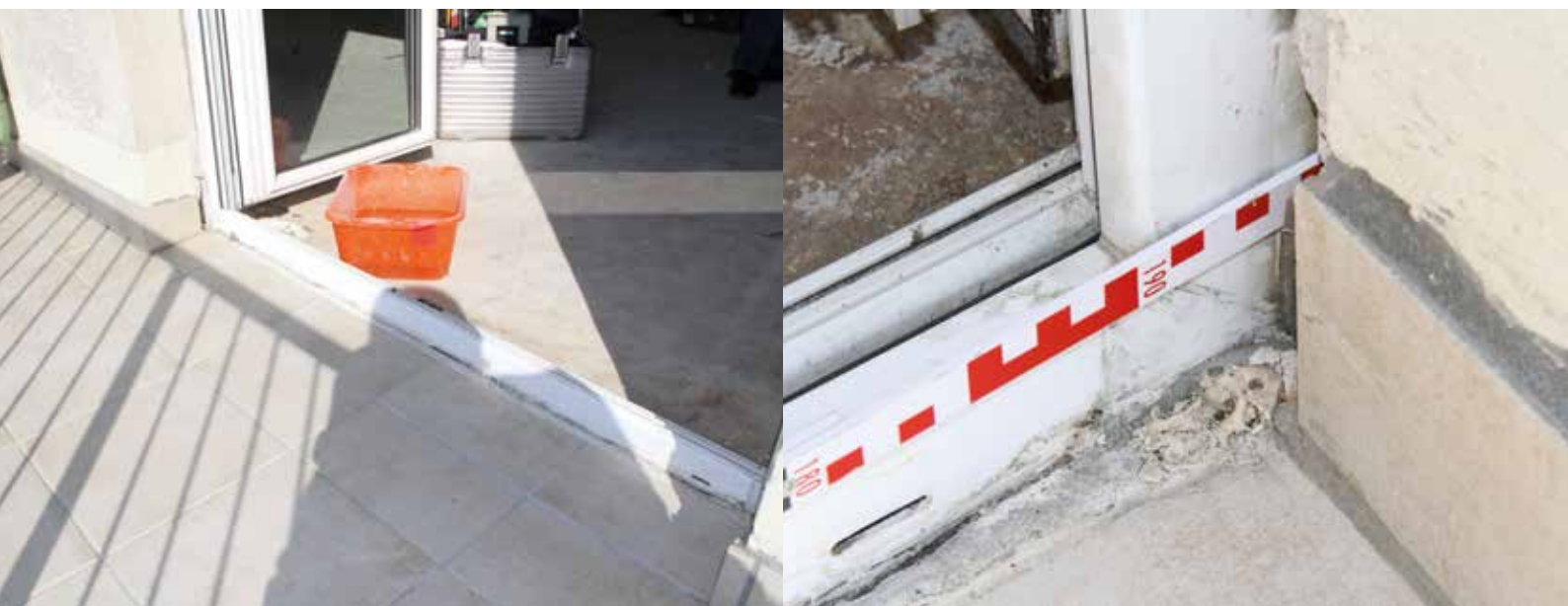
Bild 1: Die Terrassentüre im Altbestand erhalten, die Terrassensanierung wurde an die bestehenden Türstöcke angearbeitet. | Bild 2: Nach Entfernung der dauerelastischen Abdichtung zwischen Sockelfliese und dem Türstock zeigt sich, dass hier ein völlig offenes Loch vorhanden ist.
