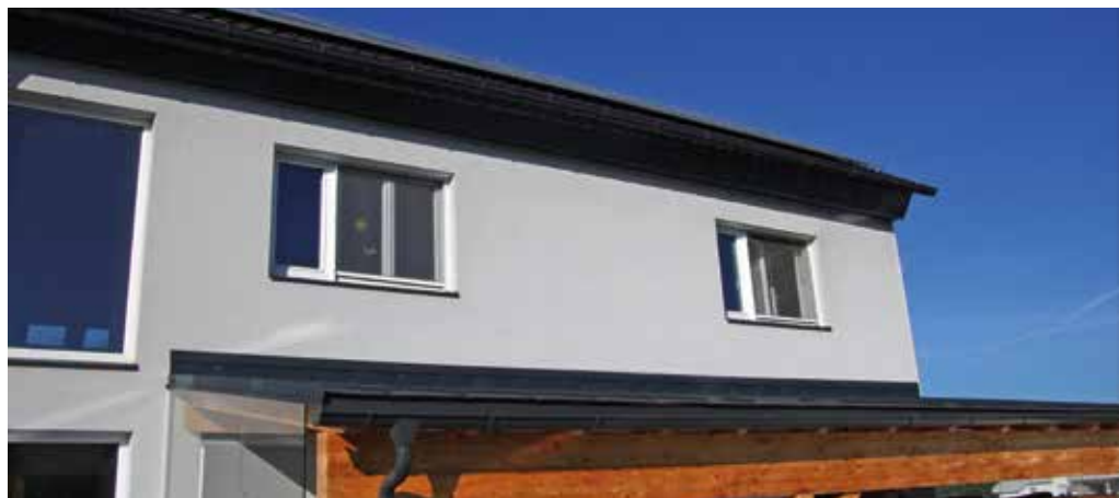
Das später angebaute Pultdach benötigt eine Kittfuge. Putzschäden an der Überlappung in der Mitte. Zuvor herkömmliche Silikonfuge ohne Schaden am Putz; nach Sanierung mit MS-Polymer sind sofort Putzschäden aufgetreten.
