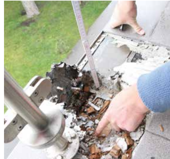
Estrich und keramische Bodenbelag entfernt, darunter der Holzbau, ohne Bauwerksabdichtung.
