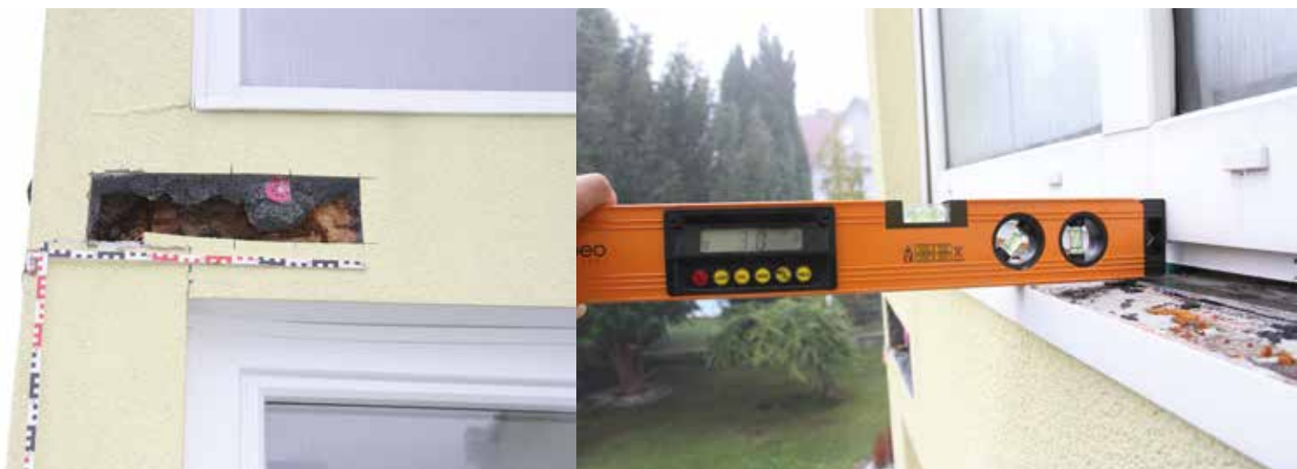
Bild links: Probeöffnungen im WDVS, darunter Holzsäule. | Bild rechts: Sohlbankresche mit Gefälle nach hinten.
