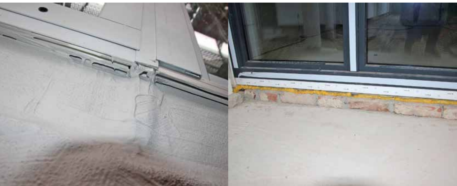
Bild links: Das Hinterlaufen der Abdichtung ist von oben durch das Fensterprofil möglich.
