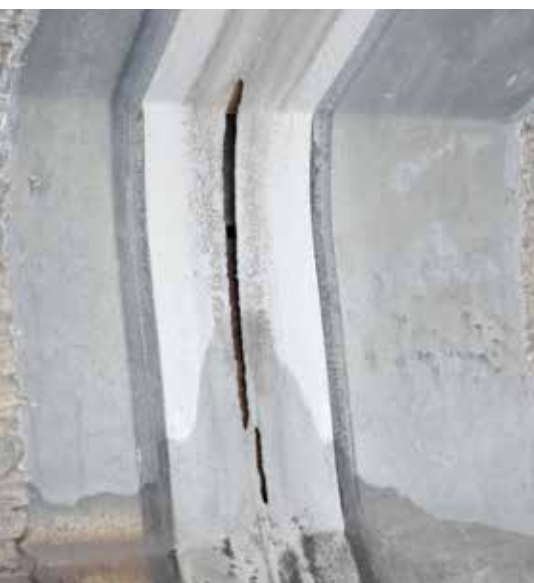
Bild 1 zeigt eine Beschädigung an einem Dehnungselement einer Einlegerinne, die über längere Zeit einen Wassereintritt verursachte.
