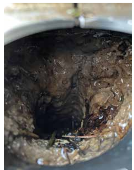
Bild 3 zeigt den einzigen Entwässerungspunkt auf einer Terrasse. Durch Kalkablagerungen war nur noch eine Entwässerungsöffnung von 25 – 30 mm gegeben.
