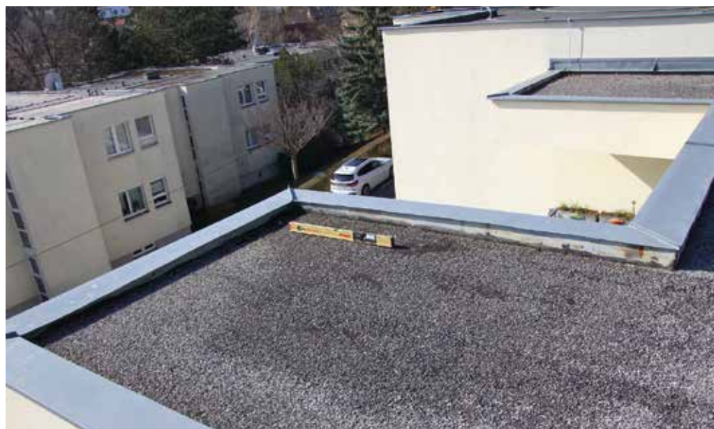
Stauwasserbereich an der Ecke der Kragplatte. Die Decke hat sich nach unten geneigt und liegt fast eben. Die Attika ist niedrig. Da sind vor der Sanierung ein paar Überlegungen anzustellen.
