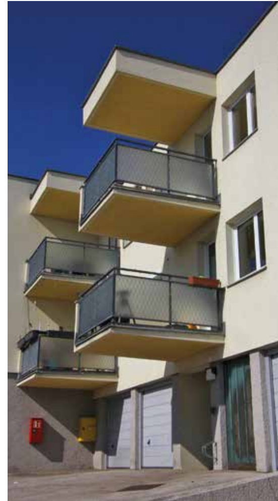
Risse oder Abplatzungen sind an den Balkonen nicht erkennbar. Verformt haben sie sich über die Zeit aber trotzdem.
