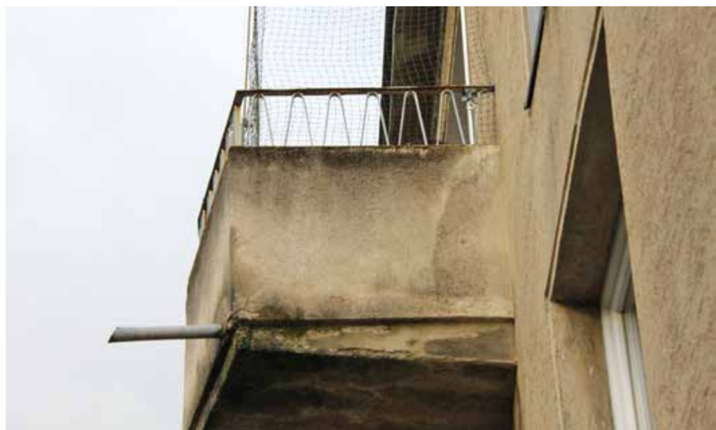
Wasserränder und Ausblühungen, Abplatzungen und Moosbewuchs an der Untersicht sind deutliche Anzeichen flächiger Unterwanderung. Sind Risse auch noch vorhanden, ist eine statische Prüfung unumgänglich.
