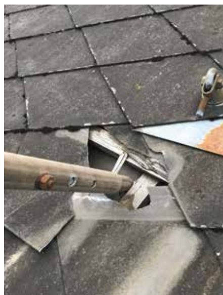
Bild 2 zeigt eine Beschädigung der Dacheindeckung, nachdem sich bei einem Sturm die Halterung eines Dachständers gelöst hat.
