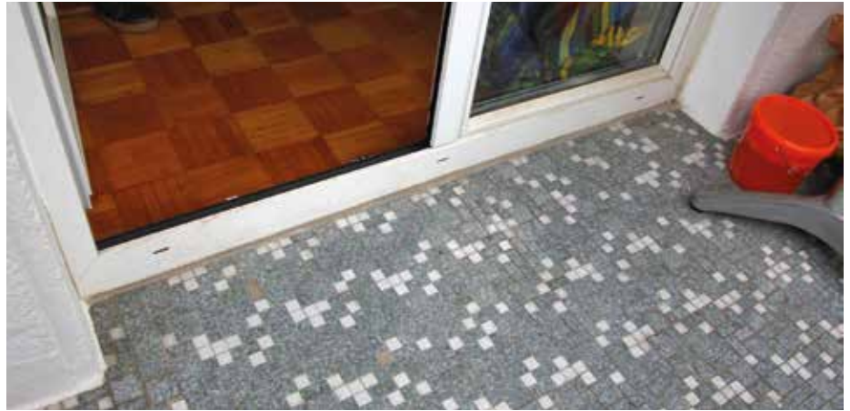
Keine ausreichende Anschlusshöhe und Übergriffsbreite am Fenster machen in der Sanierung eine normgerechte Ausführung unmöglich. Sonderlösungen sind unumgänglich.
