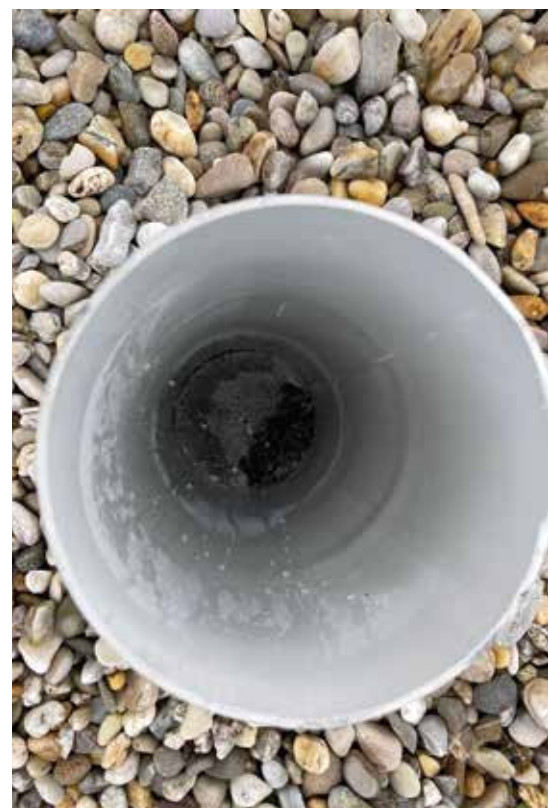
Bild 5: Optimale Inspektionsmöglichkeit, eine in den Flachdachaufbau integrierte Kontrollöffnung mit Blick auf Ebene der diffusionshemmenden Schicht über der Rohdecke.
