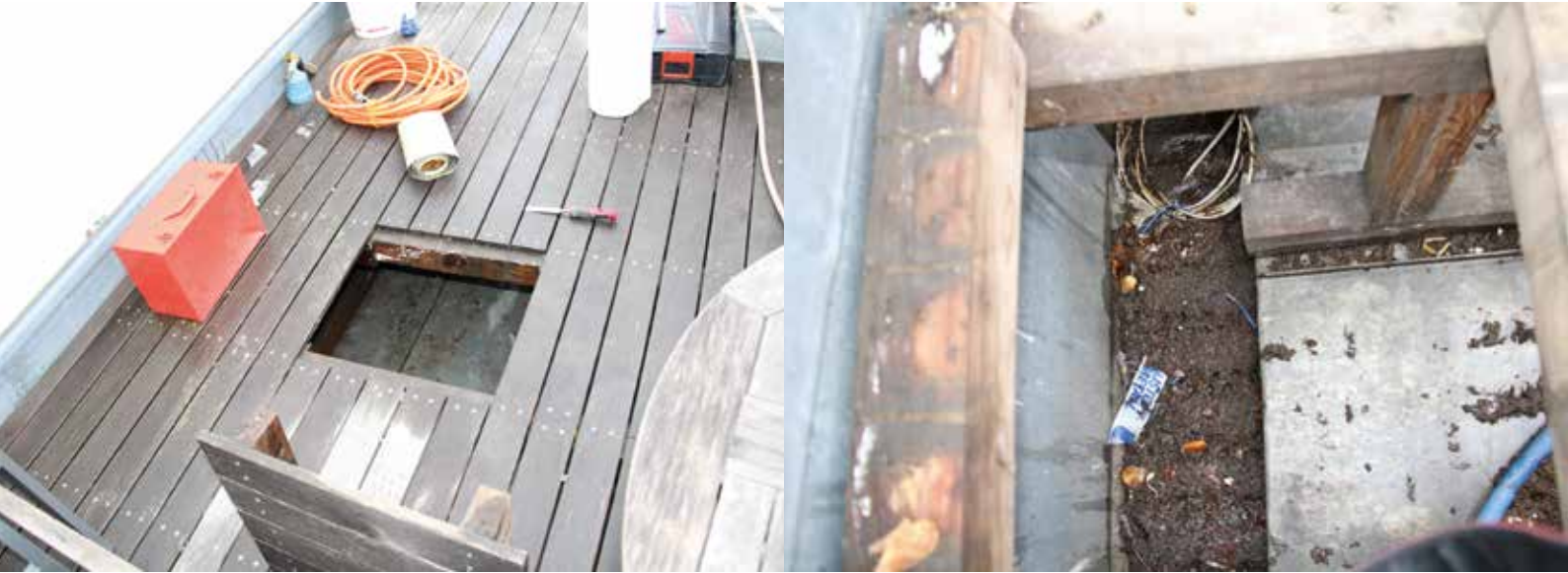
Bild 3: Die Holzterrasse von oben gesehen mit abnehmbarer Zugangsöffnung. | Bild 4: Taubenkot bis Oberkante-Einbaurinne im Übergang zum Blechdach hinter dem Kamin unter der Holzterrasse.
