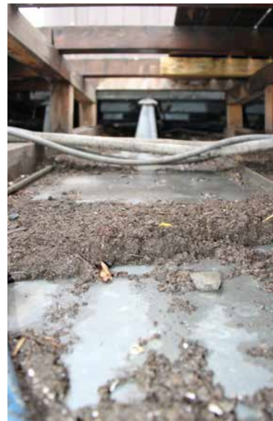
Bild 5: Taubenkot bis Oberkante-Stehfalz am Blechdach unter der Holzterrasse. Auch die Traghölzer liegen im Taubenkot.
