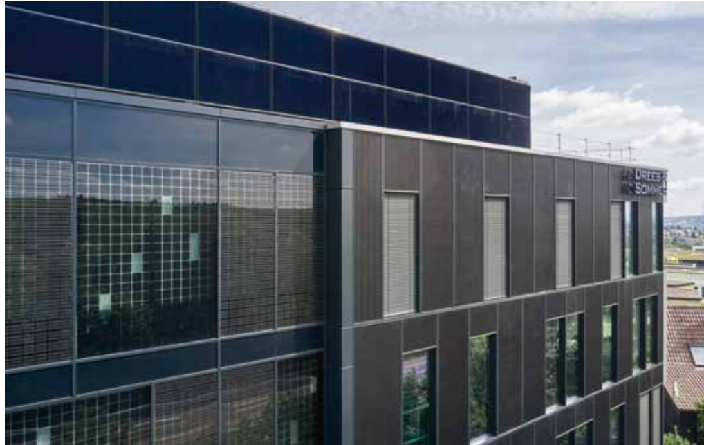
Die bei Drees & Sommer umgesetzte Fassade ist unter Berücksichtigung der Photovoltaikmodule in Summe nur 210 Millimeter dick. | Foto: © Drees & Sommer SE, Jürgen Pollak
