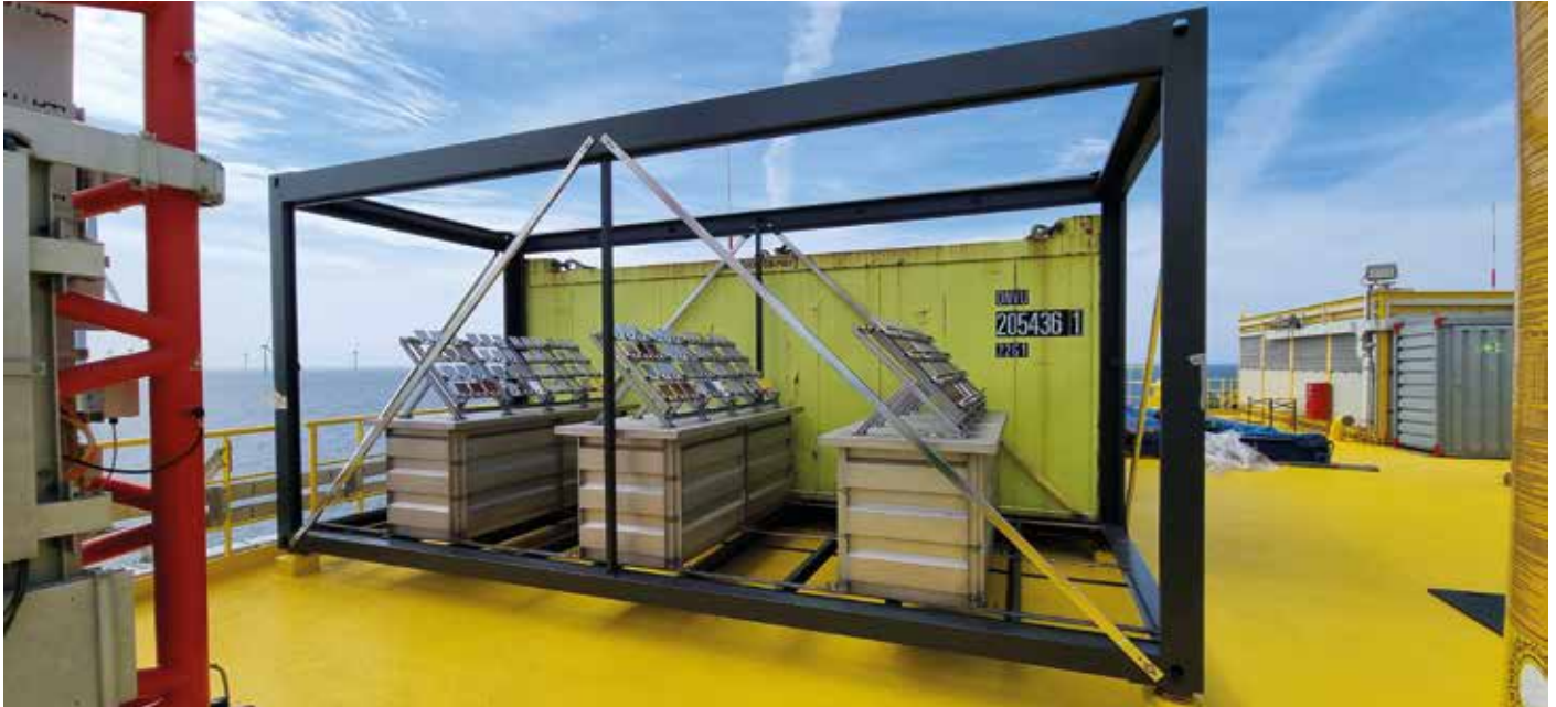
Auf der Umspannplattform (OSS) stehen die ausgelagerten Probenracks für die Bewitterungskampagne, hergestellt von der Firma MODERSOHN® Stainless Steel, aus dem Werkstoff 1.4462. | Foto: © EnBW Offshore Service GmbH
