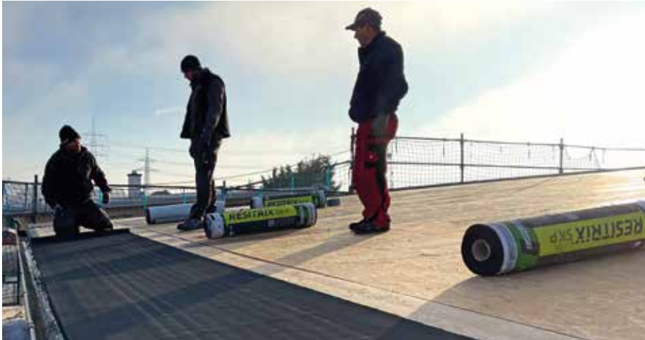
Manches muss man selbst erleben. DAPEK macht österreichweit RESITRIX-Vorführungen und Schulungen auf der Baustelle und in der Werkstatt.
