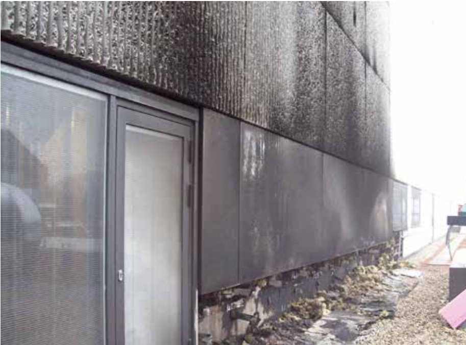
Brand beim Bau des Musiktheaters Linz. Bei Flämmerarbeiten wurde die Abdichtungsfolie der Fassade entzündet, welche in weiterer Folge zündend abtropfend die Sockeldämmung in Brand setzte. | Fotos: © BVS (4)
