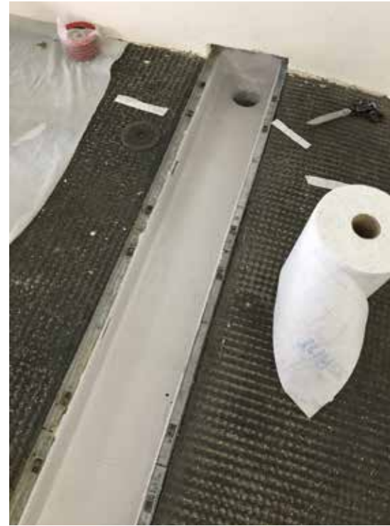
Die neue Rigolrinne ist dank Triflex ProDetail dauerhaft dicht. Weil PMMA schnell aushärtet, war die Einfahrt nach kürzester Zeit wieder befahrbar.
