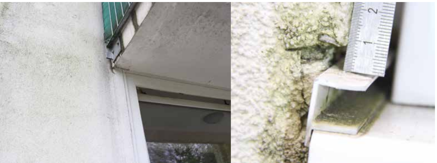
Bild links: Markante Wasserablaufspuren an der Unterkante der Betonplattenverschneidung zum WDVS inkl. Rissbildung. Bild rechts: Augenscheinlich völlig untauglicher, unsachgemäßer und undichter Anschluss-C-Vorkopf zum WDVS.
