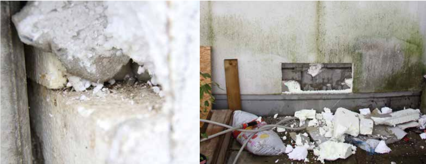
Bild links: Die geöffnete Fassade im Bereich der Balkonplattenverschneidung mit dem verfärbten Dämmstoff. Bild rechts: Die geöffnete Fassade unter dem Fenster mit den markanten Wassereinfluss Spuren.
