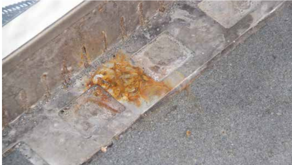
Auch im Bereich der Terrassentraufenverblechung sind bereits deutlich Weißrost- und Rotrostkorrosionsansätze erkennbar.
