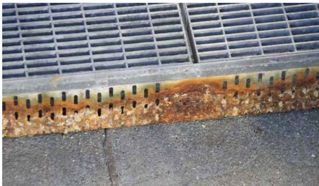
Die massive Rotrostkorrosion am feuerverzinkten Grundkörper der Rigolrinne im direkten Kontakt mit der kontaminierten Splittschüttung.
