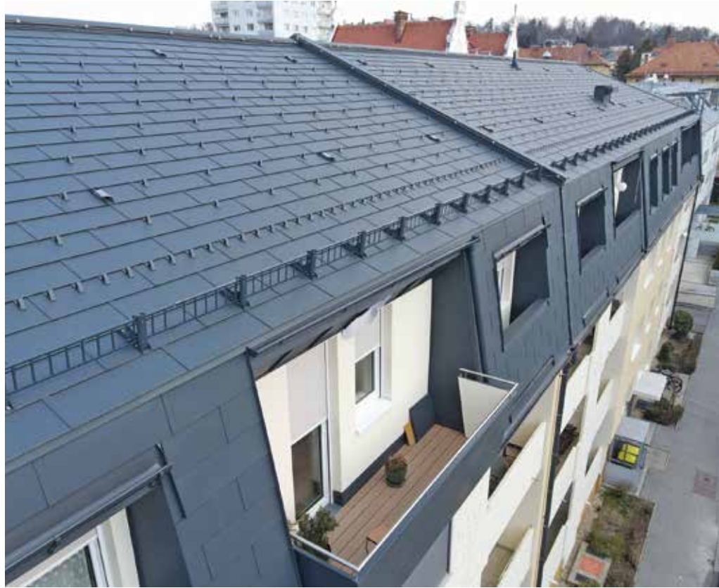
Die Absturzsicherungen und Schneeschutzgitter sind auf dem FIGO Dach montiert.
