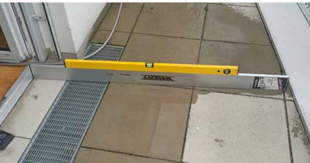
Im Bild: Balkontüre unter Notentwässerungsniveau
